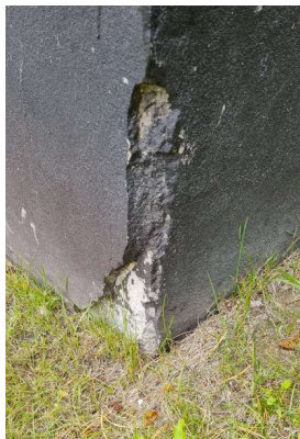
Bild 6 Sockel, bortfall av material i putsning
